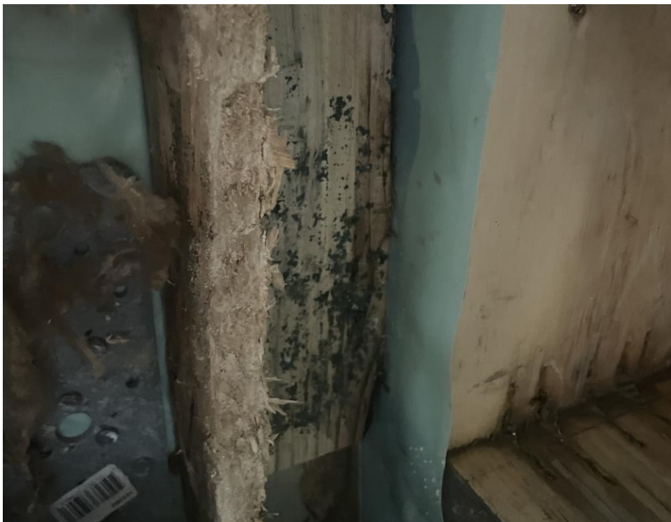
Slika 26: Pojav plesni na konstrukciji. Les je močno vlažen. Plesni so prisotne v vogalu, kjer je slab pretok zraka.
