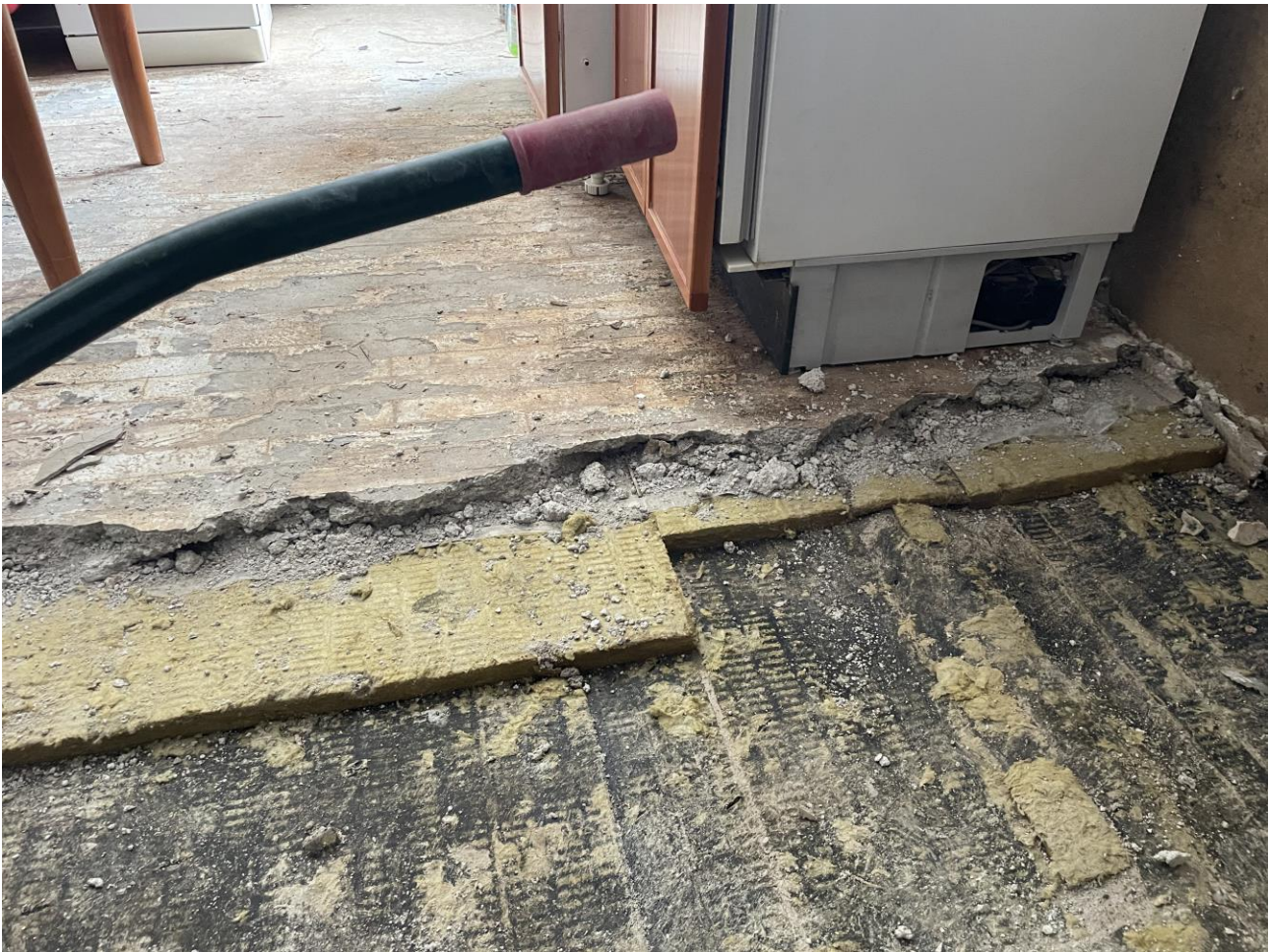
Slika 2: Odstranjevanje estriha in izolacije. Izolacija je prepojena z vodo.
