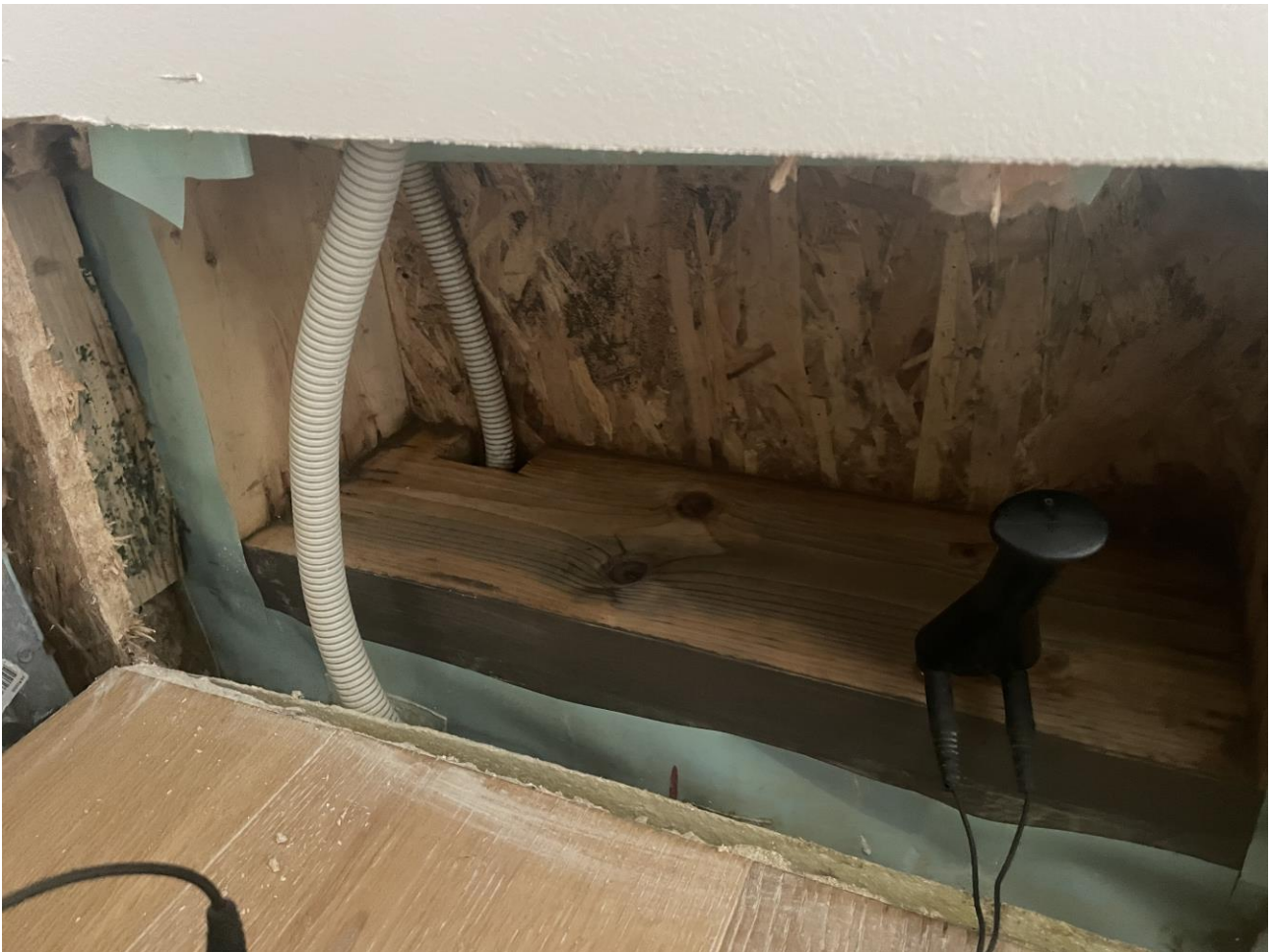
Slika 5: Parna zapora je nemešana na notranji strani. Odstranjena je tako, da jo je mogoče ponovno zatesniti. Temna barva pasnice nakazuje, da je povsem prepojena z vodo.
