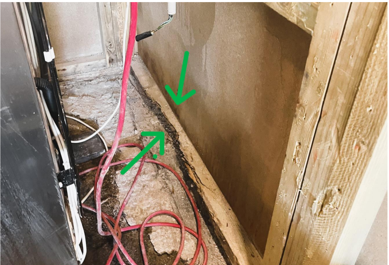
Slika 11: Primer trhle pasnice, na mestu zamakanja
