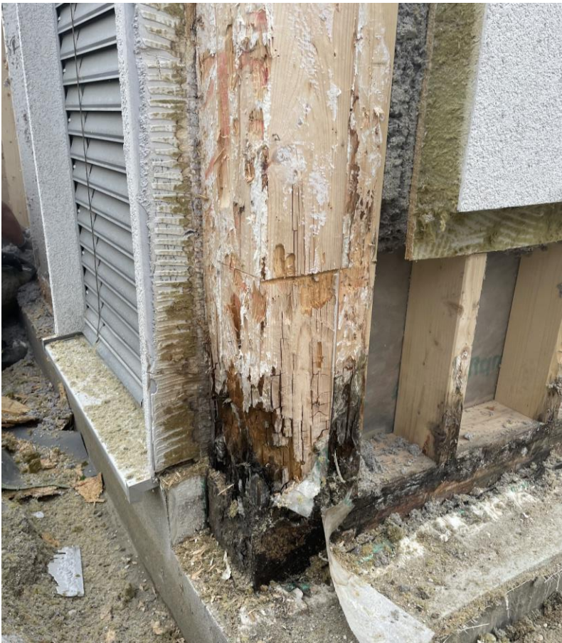
Slika 10: Primer trhlega zunanjega stebra
